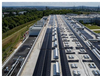
Cergy – panneaux photovoltaïques
