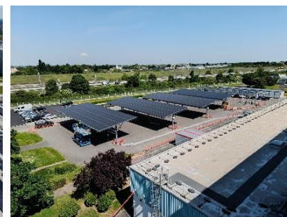
Poitiers – panneaux photovoltaïques
