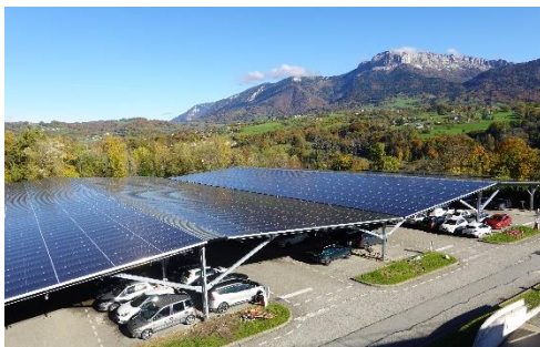
Argonay – panneaux photovoltaïques
